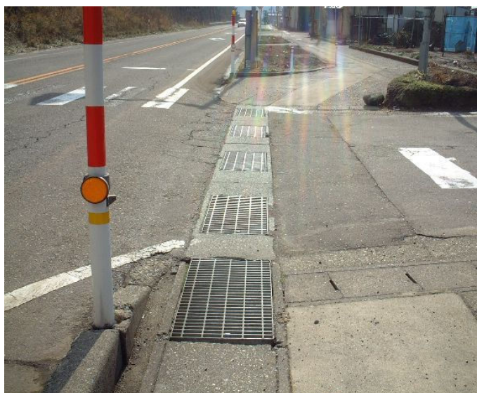
グレーチングストッパー(タイプ II 型)の設置例
