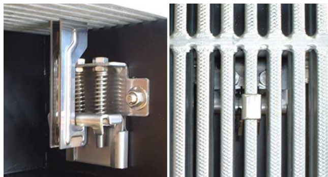
GST-SP(改良型・ダブル)の設置状況(内部/上部)
